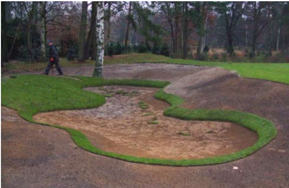
Hole 7, linkse greenbunker tijdens het leggen van de grasmatten. Er wordt eerst een mat rondom gelegd tot onderaan de bunker, dan wordt deze opgevuld met 10cm zand.
